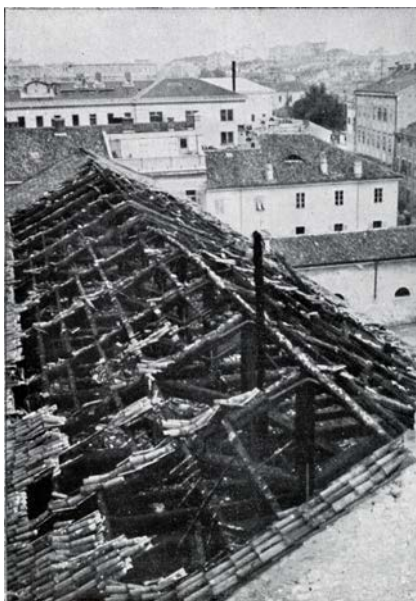
Il tetto del Duomo completamente devastato dall'incendio (foto da Schiavuzzi B., Il Duomo di Pola)
