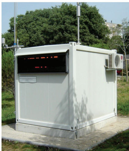
Slika 3 – Primjer izotermičkog skloništa u koji se smješta oprema za praćenje kvalitete zraka
