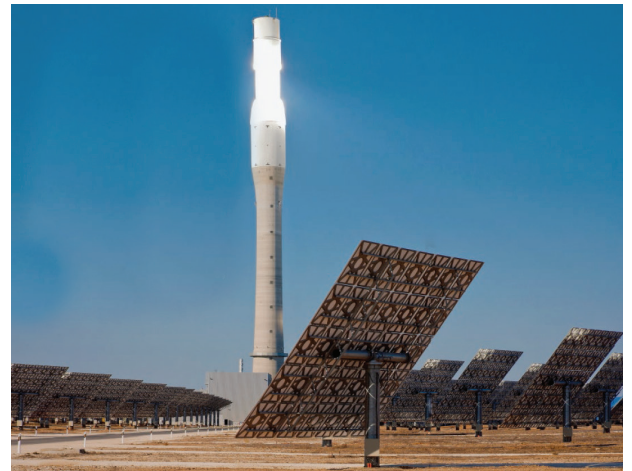
Slika 2 – Primjer elektrane CSP – koncentrirajuće solarne termoelektrane (CSP plant – concentrated solar power plant) (izvor: Sulzer: http://www.sulzer.com/ )
