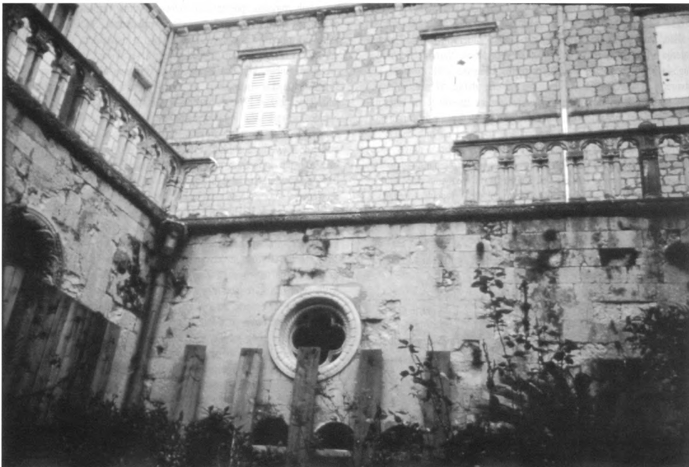
Dubrovnik, Klaustar dominikanskog samostana oštećen granatiranjem Fototeka MDC-a, Zagreb
