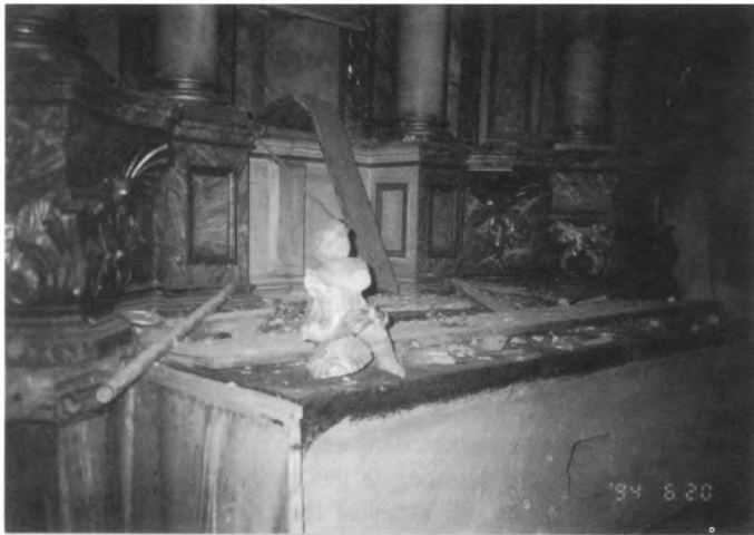
Kamensko, Dio oštećenog oltara župne crkve Marije Snježne Fotodokumentacija ECCM HQ, Humanitarian Section, Zagreb, lipanj, 1994.
