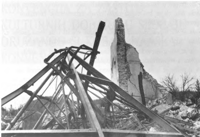
Voćin, ožujak 1992. Ruševine i ostaci konstrukcije krovišta crkve Blažene Djevice Marije od Pohoda.
