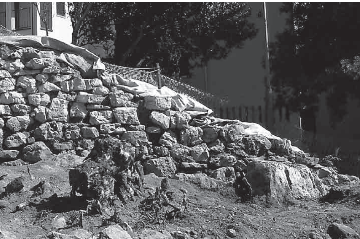
Slika 7. Pogled na unutarnje lice istočnog zida SJ 006 (snimio D. Bužanić, Arhiv HRZ)
