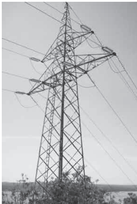
Slika 38. Stup dalekovoda na vršnom dijelu kotorskog brijega (2012., snimila J. Doričić).
