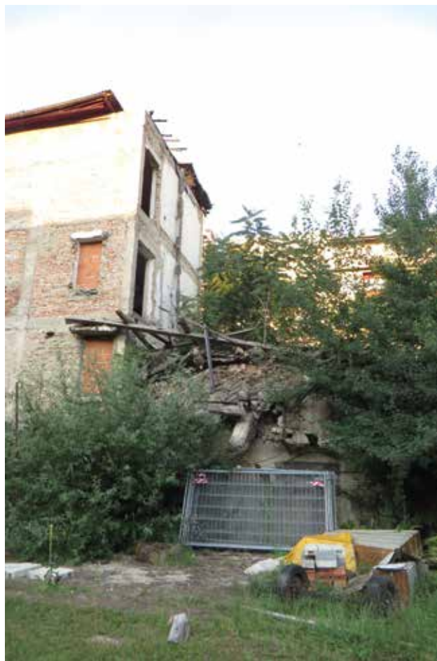
25 Detalj urušenog dijela (bivša zgrada za dobrobit radništva) (foto: M. Pretković, 2015.)
