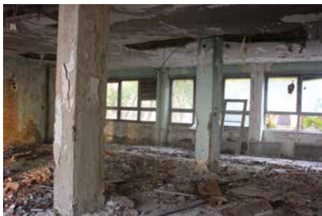
16 Oštećenja u unutrašnjosti tvorničke zgrade (1. kat) (foto: M. Pretković, 2013.) Damages to the factory building interior (1 st floor), (photo: M. Pretković, 2013)
