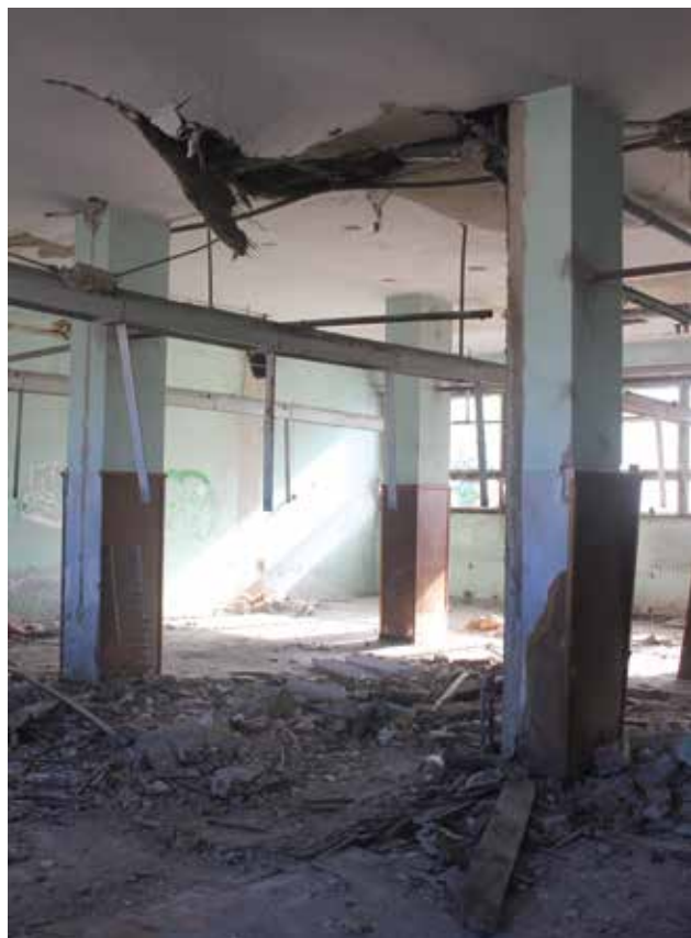
17 Oštećenja u unutrašnjosti tvornice (foto: M. Pretković, 2013.) Damages to the factory interior, (photo: M. Pretković, 2013)
