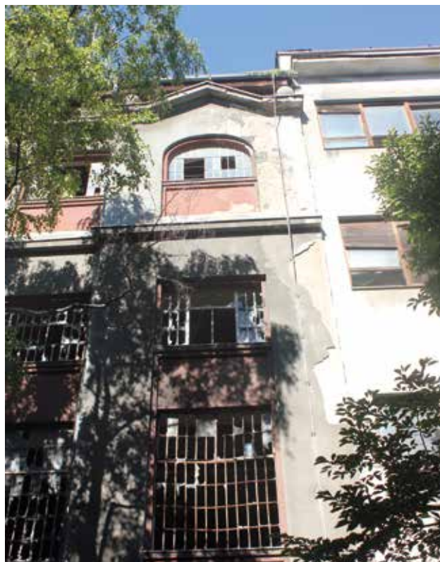
14 Detalj oštećenja prozora na pročelju u Erdödyjevoj ulici (foto: M. Pretković, 2013.) Detail of damage to the window on the facade facing Erdödyeva Street (photo: M. Pretković, 2013)
