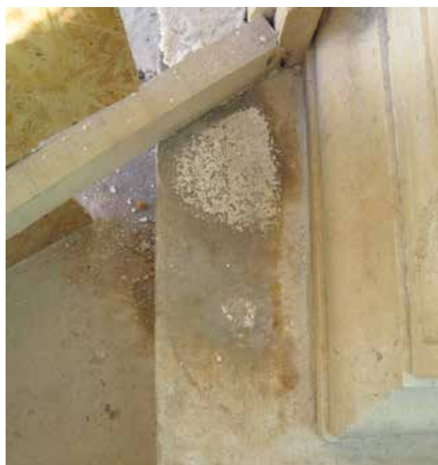
23 Nakon čišćenja kalcitnih naslaga (foto: P. Ajduković, 2013.) After cleaning of calcite sediments (photo: P. Ajduković, 2013)
