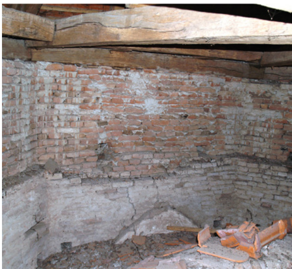
7. Tavan, povišenje zidova svetišta i ostaci gotičkog svoda (fototeka KO u Varaždinu, snimila M. Korunek, 2010.)
