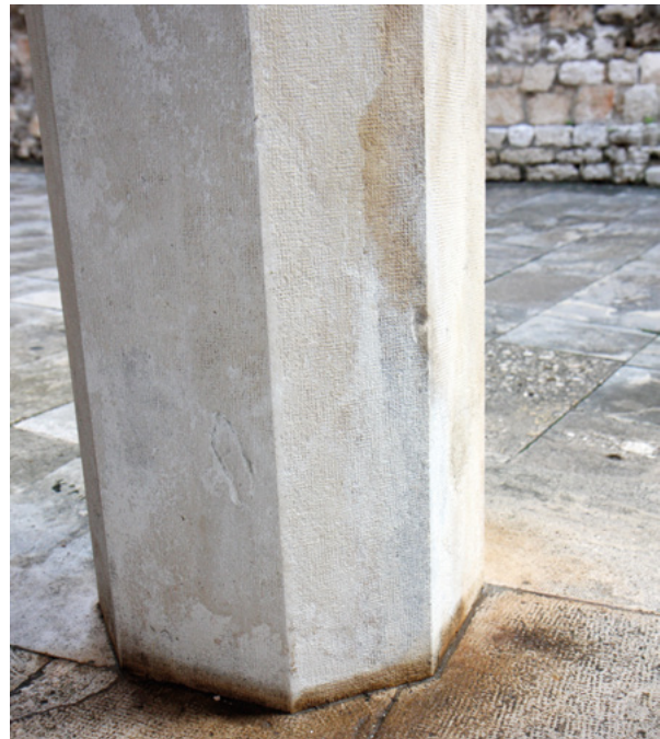
5. Cvjetanje, iscvjetavanje, ili eflorescencija? Ulaz u kuću Male lođe u Šibeniku (snimila K. Hraste, 2014.) Blooming, flowering, or efflorescence? Entrance to the house of the Small Loggia in Šibenik (photo by K. Hraste, 2014)
