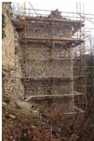
Slika 13. Zapadni zid kapele utvrde Grebengrad, stanje tijekom radova (foto: Marijana Korunek, 2014. g., KOVŽ)
