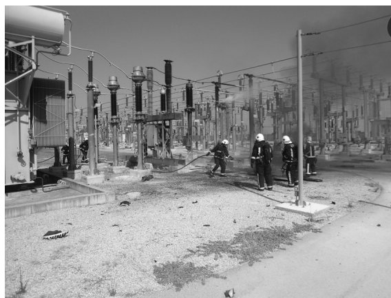
Slika 1. Požar na visokonaponskom postrojenju
