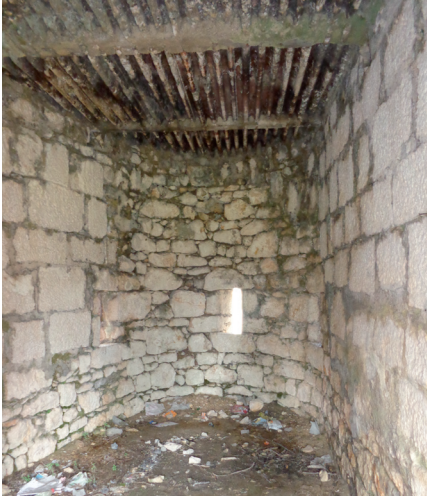
Unutrašnjost obrambenog kaponira na krovu je vidljiva armatura od valovitoga čeličnog lima i čeličnim gredama
