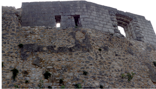
Vidljiva je nova gradnja na starim zidinama. Veliki otvor desno je toparnica a lijevo su otvori za lako pješačko naoružanje
