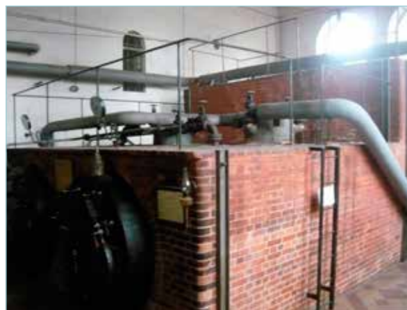
Slika 5: Pogled na dio uređaja i parna kotlovnica u objektu
