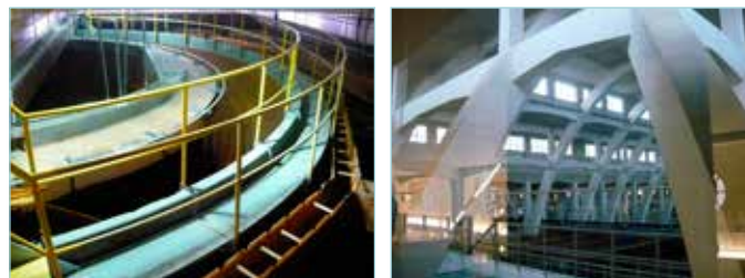
Slika 1 Kružni taložnik i filterska hala
