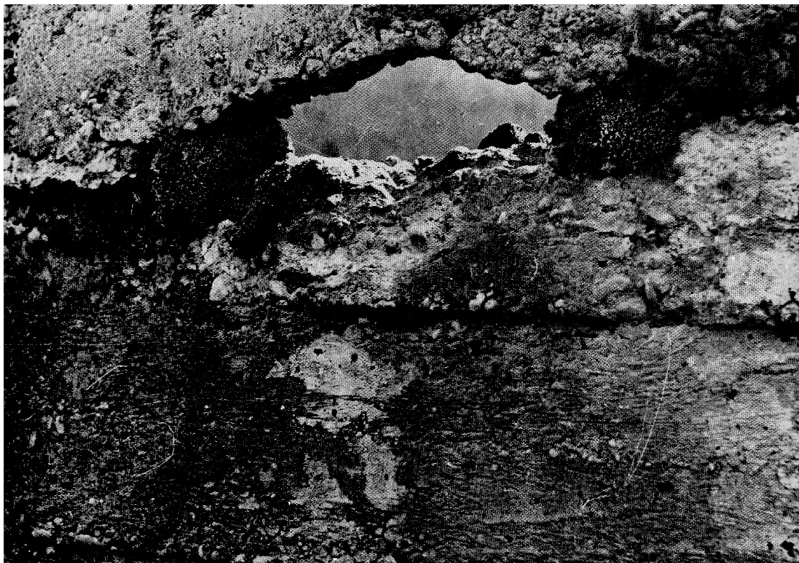
Sl. 2. Korozija betona zida rashladne kule uzrokovana rastom mahovina.
