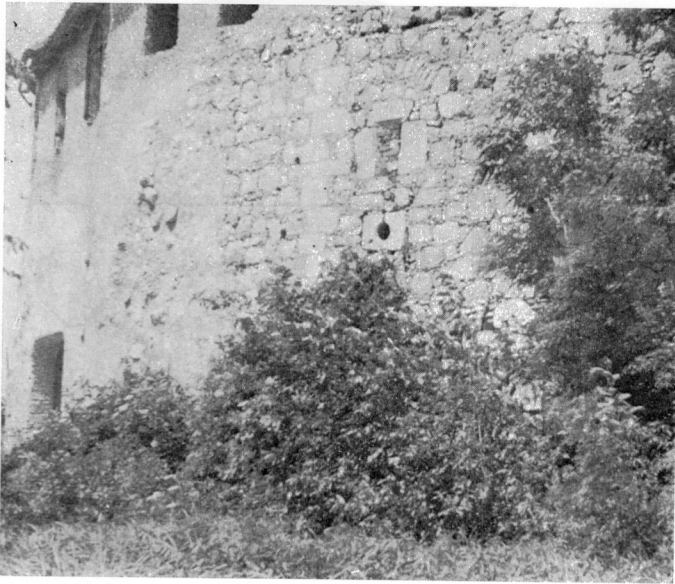
22 Pogled na istočni dio zida; lijevo novo probijeni kolni ulaz i trag zida odstranjene kule (?)
