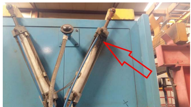
Slika 7 Propuštanje vidljivo i potvrđeno
