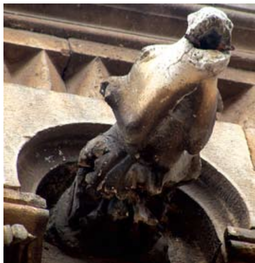
Zatečeno stanje glave vodorige na južnom pročelju Trogirске katedrale
