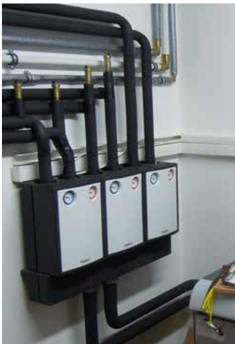
Slika 1. Kućni razvod – središnji kolektor
