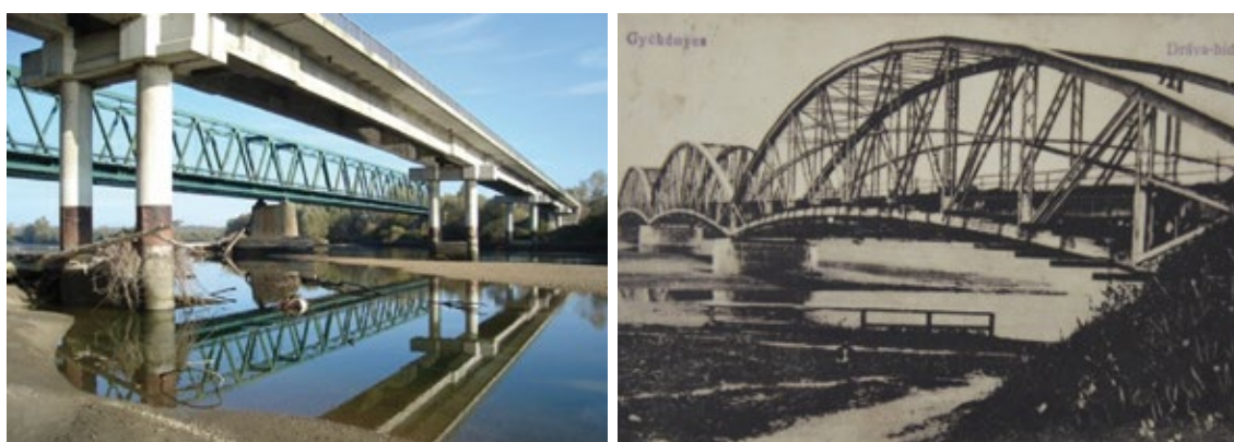
SI. 4. Važniji suvremeniji mostovi preko Drave. Današnji masivan jednokolosiječni željeznički most »Drava-Botovo« na stacionaži 523+749 (uzvodno). Ukupna dužina mosta je 291 m, visina 10 m
