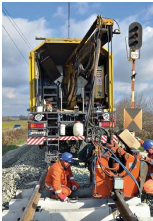
SI. 5. Radovi na pruzi Koprivnica-Botovo-državna granica koji podrazumjevaju mijenjanje kompletne kolosiječne rešetke (pragovi i tračnice) 2014. godine
