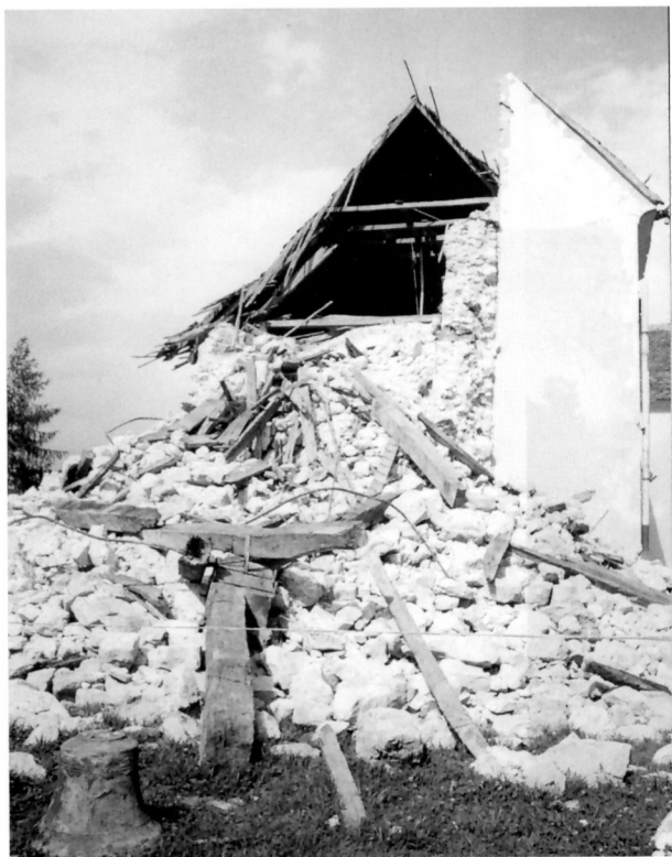
10. Župna crkva sv. Petra u Orehovcu, stanje nakon urušavanja zvonika 2001.
