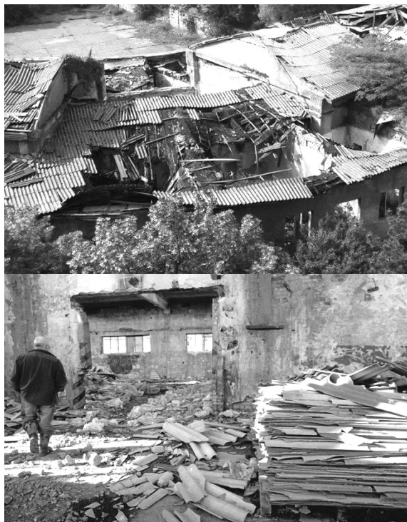
Slika 4. Primjeri oštećenih objekata kao izvora azbestne prašine
