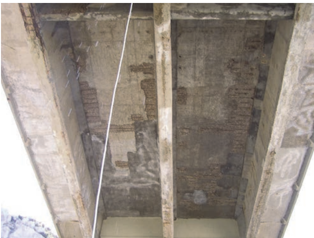
Slika 13. Podgled prve trećine polja kolničke konstrukcije raspona U5-S31 nakon uklanjanja oštećenog betona [14]
