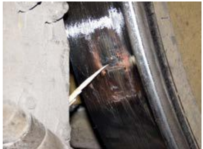
Slika 3. Ravna mjesta na kotrljajućoj površini kotača
