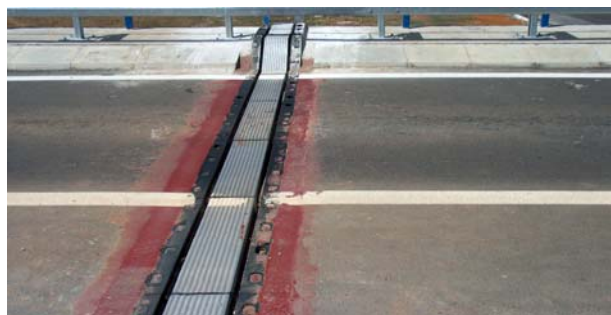
Slika 7. Nadvožnjak u čvoru Gornja Ploča na autocesti Zagreb-Split (prijelazna dilatacijska naprava ugrađena nakon završetka asfaltnih radova)
