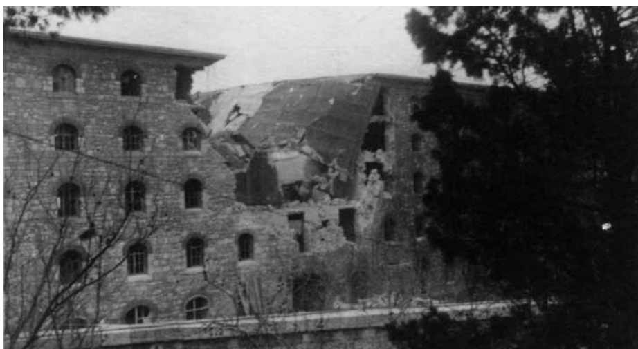
Il Magazzino tabacchi presso l'ex Arsenale pesantemente danneggiato dai bombardamenti.
