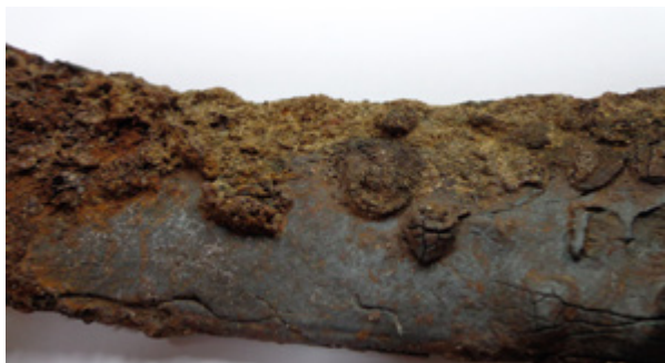
4. Vidljiv originalni sloj ispod produkata korozije (fototeka HRZ-a, snimila E. Perković)
