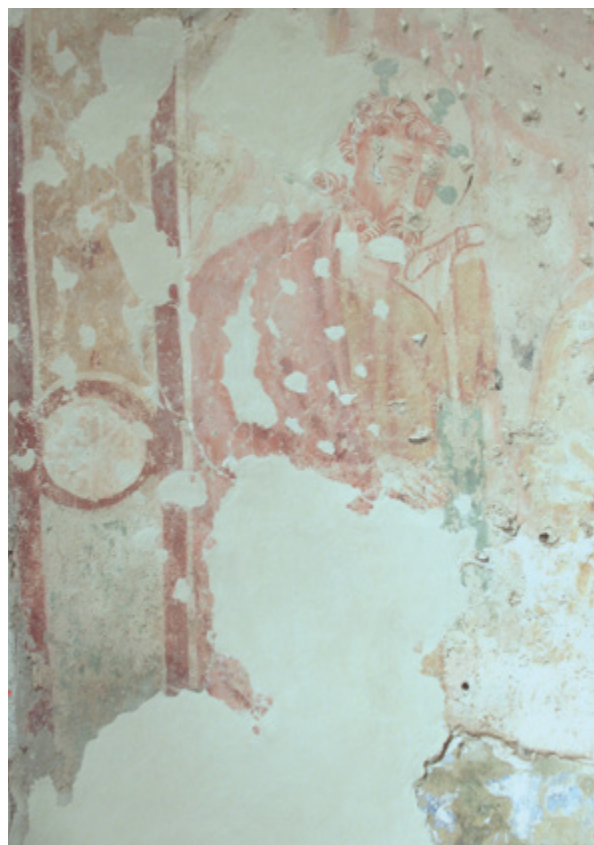
21. Područje testne osi nakon provedbe zaštitnih mjera (snimio B. Hacker, 2009.) Endangered area of the test axis after implementing the protective measures (photo by B. Hacker, 2009)
