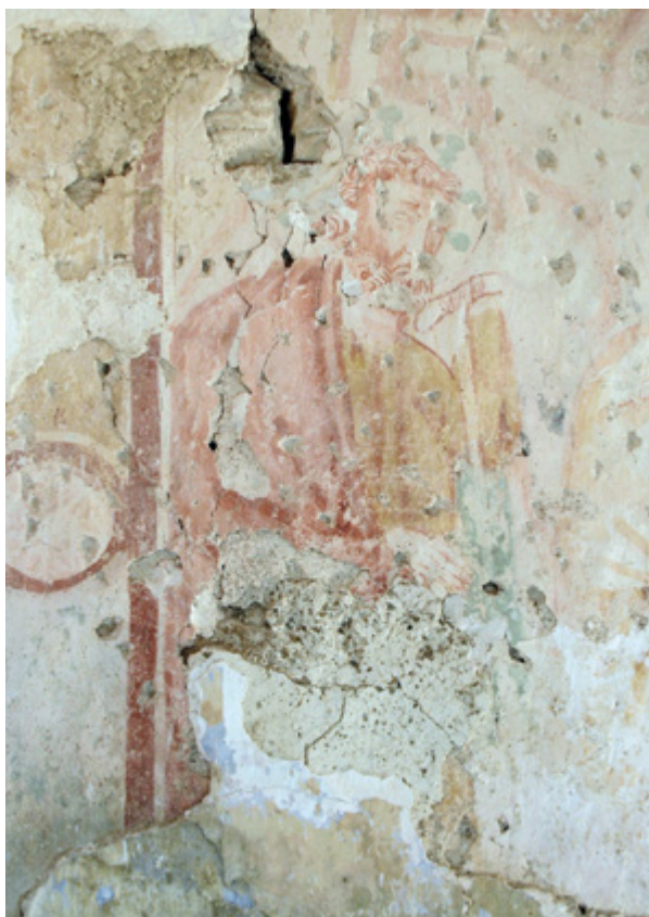
20. Ugroženo područje testne osi prije provedbe zaštitnih mjera (snimio B. Hacker, 2009.) Endangered area of the test axis before implementing the protective measures (photo by B. Hacker, 2009)
