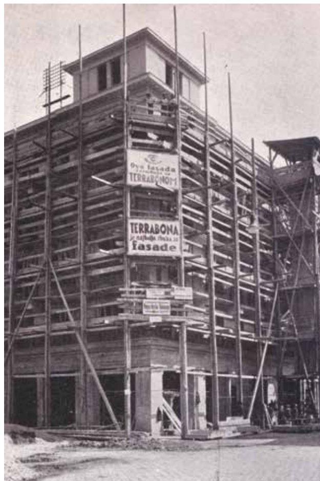
26 Pogled na ugao Ulice Antuna Bauera 11 i Ulice fra Grge Martića 16 u vrijeme gradnje zgrade Bajok prema projektu Ive Marčelje 1930.
