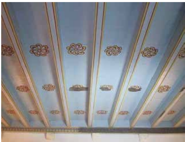
37 Izgled tabulara kapitularne dvorane nakon radova restauracije i rekonstrukcije oslika (foto: G. Sava, 2000.)
