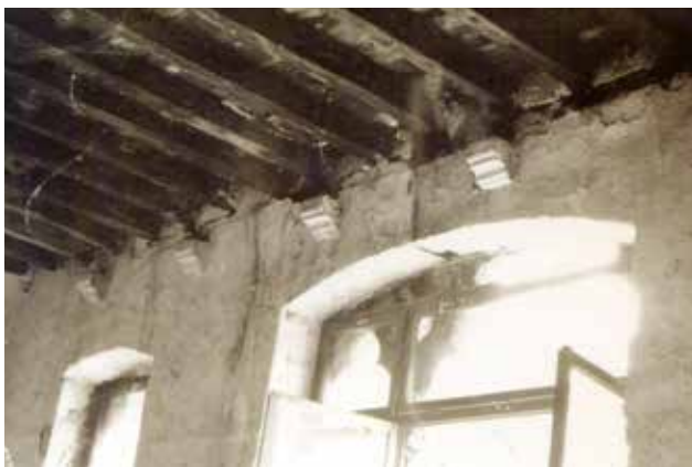
24 Stanje konstrukcije drugog kata prije rekonstrukcije građevine (izvor: Fototeka Konzervatorskog odjela u Splitu, 1973.)
