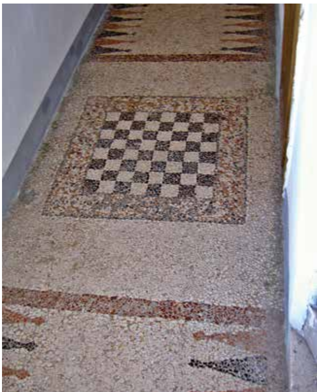
8 Pod u stubištu palače Tambača-Peegrini, stanje 2015. (foto: I. Šprljan) Floor of the stairwell in the Tambača-Peegrini palace, state in 2015 (photo: I. Šprljan)
