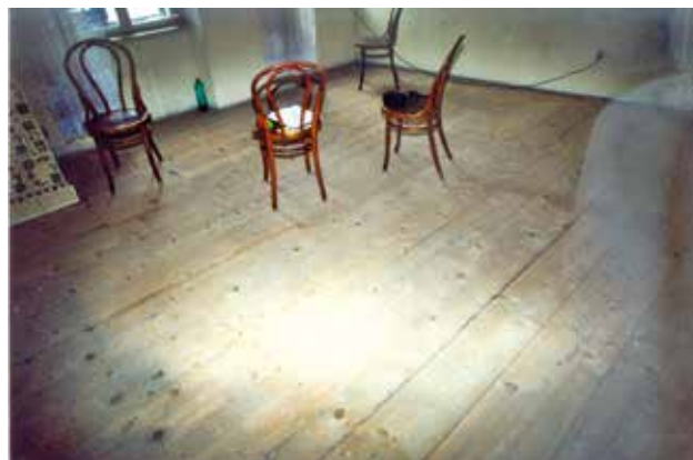
17 Kuća na k. č. 5262, daščani pod, stanje 2001. (foto: I. Šprljan) House on cadastre lot 5262, wooden board floor, state in 2001 (photo: I. Šprljan)
