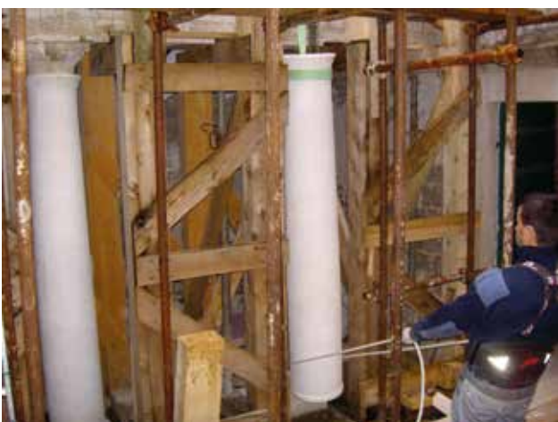
16 Montaža desnog stupa prizemlja (foto: I. Šprljan) Assembly of ground floor right pillar (photo: I. Šprljan)
