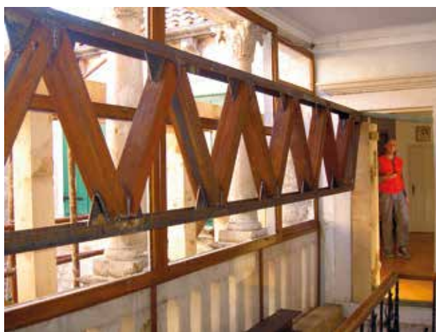
14 Montaža čelične rešetke (foto: I. Šprljan) Assembly of steel grid (photo: I. Šprljan)
