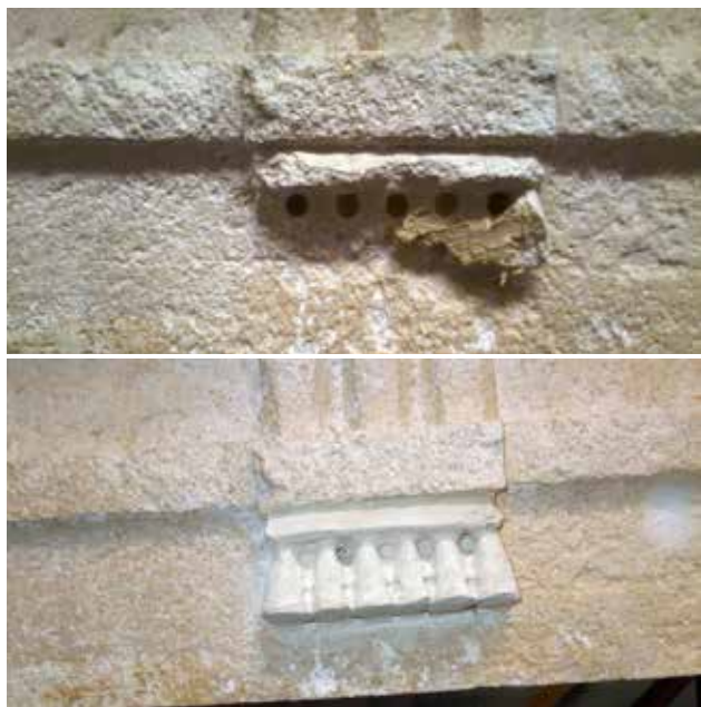
24 a Nanošenje tašela „na mokro“ (foto: S. Pranjić) i 24 b: završna klesarska obrada tašela (zakrpe) „na mokro“ na resicama triglifa arhitravne grede (foto: S. Pranjić) Application of patch „in the wet“ (photo: S. Pranjić) and 24 b: final stone carving treatment of patch „in the wet“ on the tassels of the architrave beam triglyph (photo: S. Pranjić)
