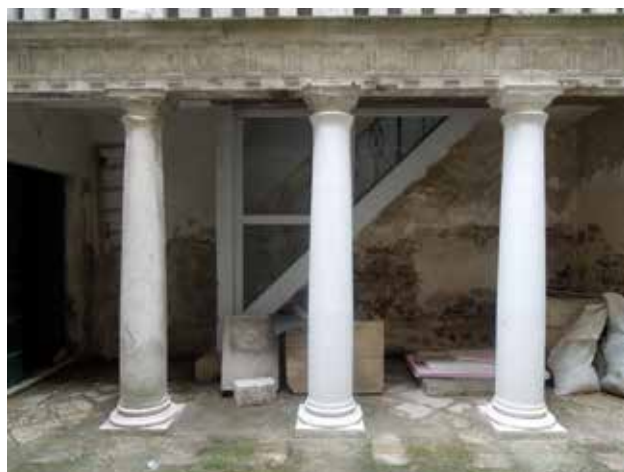
17 Pogled na stupove prizemlja nakon montaže (foto: S. Pranjić) View of ground floor pillars following assembly (photo: S. Pranjić)
