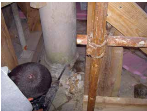
15 Demontaža stupa, izbijanje baze (foto: I. Šprljan) Dismantling of pillar, breaking out of the base (photo: I. Šprljan)
