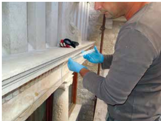
21 Injektiranje pukotina na arhitravnoj gredi viskoznom epoksidnom smolom (foto: Š. Glavan) Injecting fissures on the architrave beam with viscous epoxy resin (photo: Š. Glavan)
