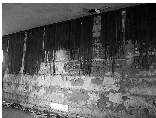
sl.10.-11. Unutrašnjost nadograđenog objekta i vidljiva oštećenja zidova i stropa.
