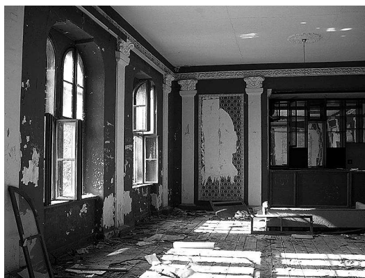
sl.16. Unutrašnjost nadograđenog objekta i vidljiva oštećenja.
