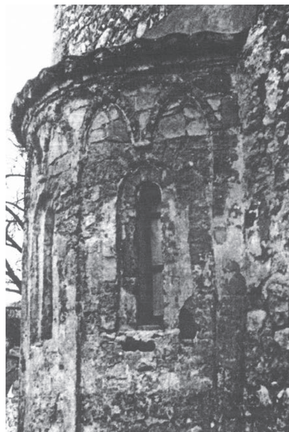
Fig. 3. Rubik, chiesa del Salvatore, particolare dell'abside prima dei restauri (da A. Meksi, 2004).
