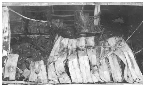
Slika 2. Tragovi požara na krovnoj konstrukciji objekta Figure 2. Traces of fire on the roof structure of the building
