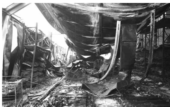
Slika 3. Tragovi požara na nosivoj konstrukciji i unutrašnjosti objekta Figure 3. Traces of fire on the bearing structure and building interior
