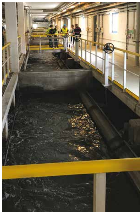
Slika 6: U obilasku UPOV-a – aerirani pjeskolovi izvedeni su u zatvorenom objektu (snimio D. Nakić)
