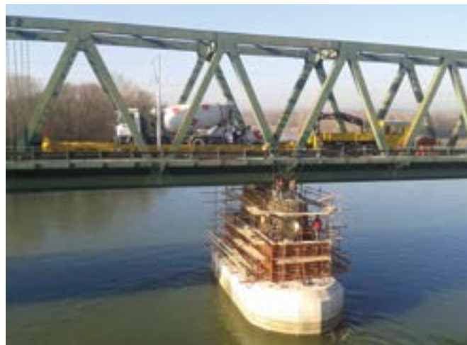
Slika 3. Betoniranje prve kampade ojačanja stupa S3 izravno iz automiješalice dovezene na mjesto ugradnje na niskopodnome vagonu
