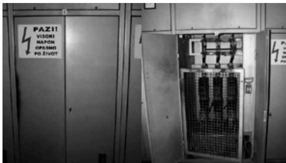
Slika 6. Znak upozorenja i tragovi na rasklopnom postrojenju
