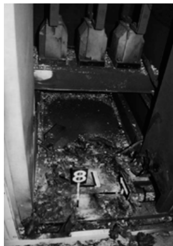
Slika 8. Tragovi na mjestu događaja u trafostanici
