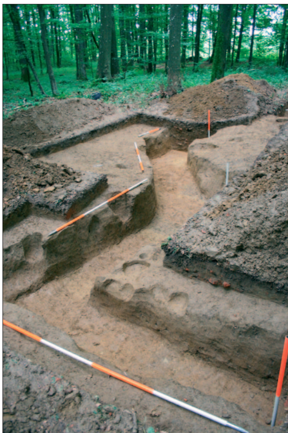
Sl. 5 GPŠO-2, pogled sa sjeverozapada na ukop za temelje sakralnog objekta u sondi 5, u prvom planu moguća sakristija, dalje na fotografiji dio apside (snimila: T. Tkalčec)
