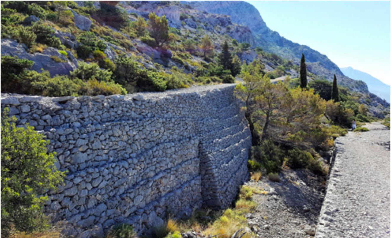
9. Podzid sa stepenastim vanjskim licem i naknadnim ojačanjem Retaining wall with a cascading mantle and subsequent enforcement
