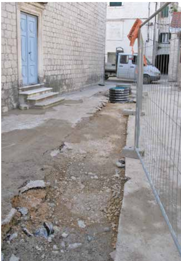
19 Trasa novog cjevovoda uz baroknu crkvu sv. Ivana Krstitelja (foto: I. Pleština, fototeka Konzervatorskog odjela u Trogiru, 2016.)
