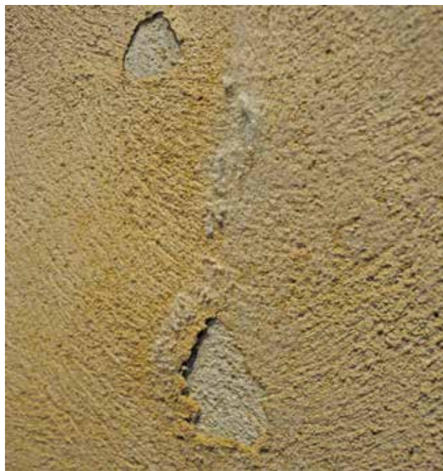
4 Oštećenja završnoga sloja žbuke uzrokovana kristalizacijom soli (foto: S. M. Sunara, ožujak 2014.)
