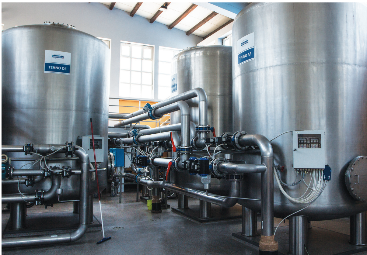
Slika 21: Detalj crpilišta i uređaja za preradu pitke vode u Donjem Miholjcu
