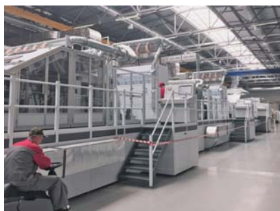
Sl.3 Dio pogona tvrtke Rusvata s instaliranom češljaričom tvrtke Trützschler u liniji za izradu netkanog tekstila
