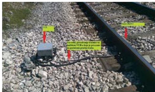
Slika 2. Izvedeno stanje, izjednačavanje potencijala između vanjskih elementa uređaja SPA-2B/CR
