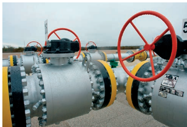
Slika 10. Detalj plinske stanice
