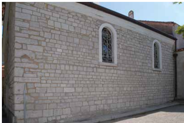
5. Crkva sv. Jakova, južno pročelje (foto: Foto Luigi, Opatija i Lovran) St James' church, south façade
