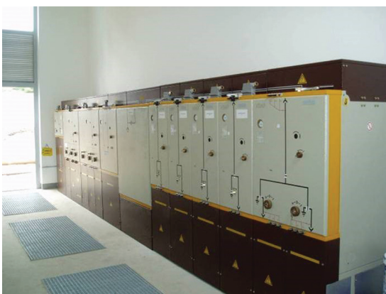
Slika 3. Prikaz složene konfiguracije VDAP aparature u TS 10(20)/0,4 kV- tvornica stočne hrane Varaždin
